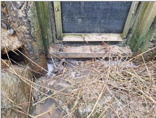
Affouillement sous l'ouvrage.
