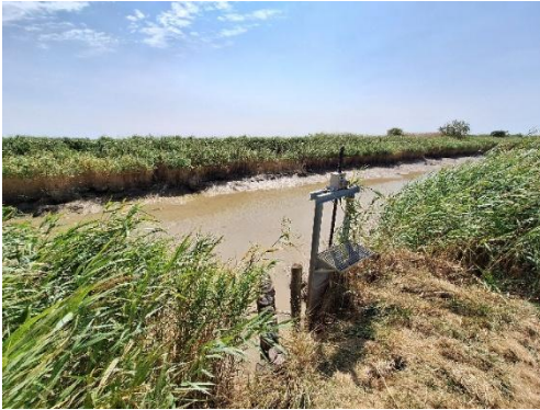
Bascule de l'ouvrage et érosion côté canal d'une partie du pied de l'ouvrage
